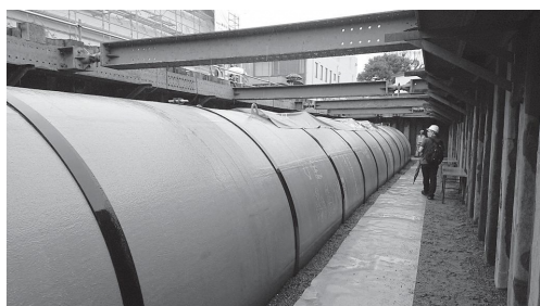
写真-4 にぎわい創出広場地下の耐震性防火水槽
